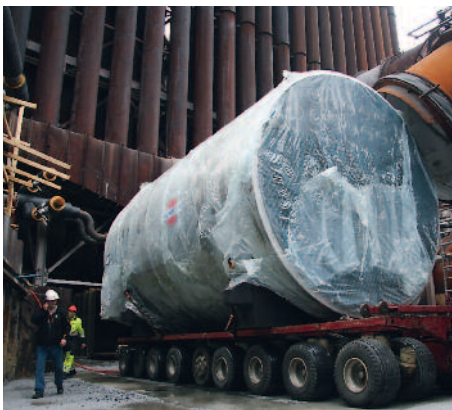
Den nye kjelen ble transportert på plass og sto klar for montering i slutten av september 2011. Foto: MIP-Info.
